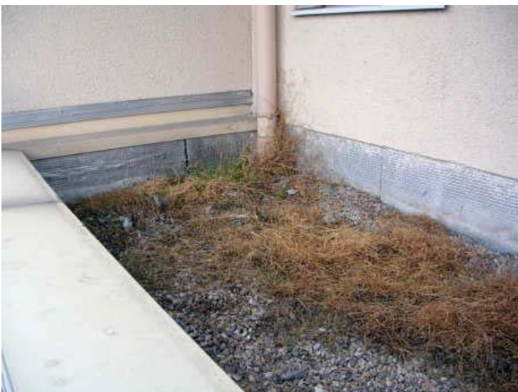
↳ Vue de la toiture au-dessus des dégâts
